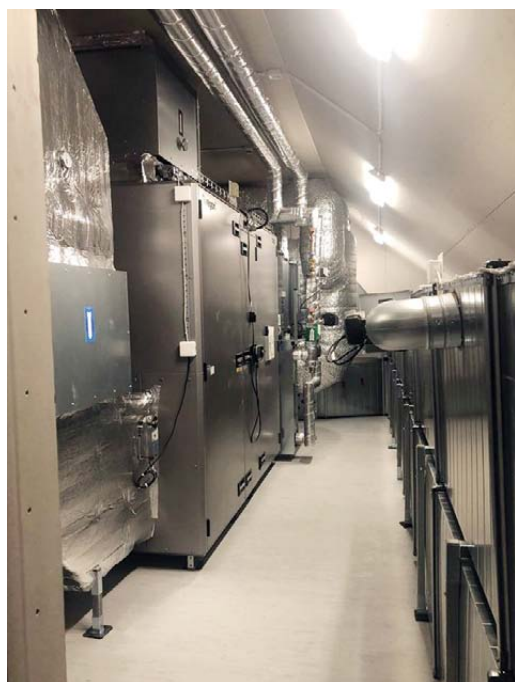
Rys. 4. Poddasze szkoły z zamontowaną centralą wentylacyjną GOLD RX
