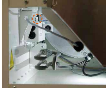
Reset-Taste für den Übertemperaturschutz am Lufterhitzer der Nachheizung (nur Modelle mit elektrischem Lufterhitzer)
