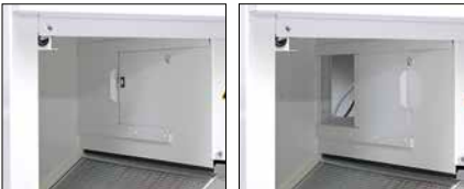
Bypass am Wärmetauscher: Die Klappe ist im Winter geschlossen und im Sommer geöffnet.
