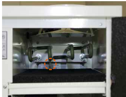
Reset-Taste für den Übertemperaturschutz am Lufterhitzer der Vorheizung
