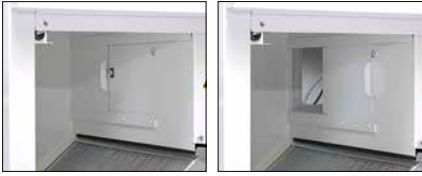
Lämmönvaihtimen ohitus: talvella luukku on kiinni, kesällä auki.
