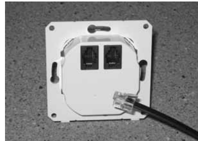
Anschluss des Steuerkabels.
