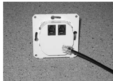
Anschluss des Steuerkabels.
