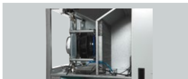
Direktangetriebene Ventilatoren mit EC-Motoren
