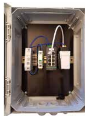
INSIDE Connect dans une armoire électrique avec un switch
