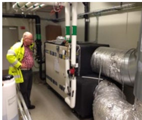
Drifttekniker Björn Adler vid ett av GOLD-aggregaten. Foto: Swegon
