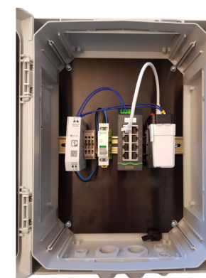
Fig. 6. INSIDE Connect dans une armoire électrique avec un switch.
