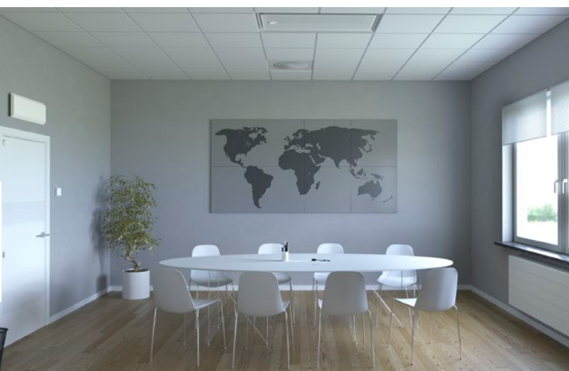
Sala de reuniones con selector de valor de consigna y regulación del aire en función de la demanda, así como refrigeración por agua y control de los radiadores.
