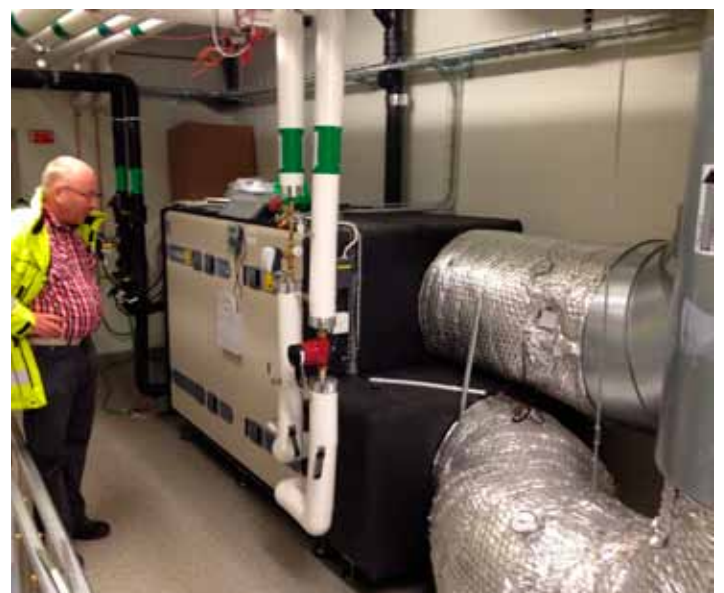
Driftekniker Björn Adler vid ett av GOLD-aggregaten. Foto: Swegon
