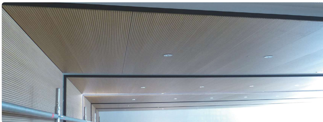
Fertig montierte Heiz-/Kühldecke mit echtholz-furnierten VARICOOL Special Solutions Paneelen.
