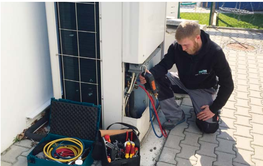
Hier führt ein Monteur die Wartung an einer VRF-Außeneinheit auf dem Firmengelände von F+S Kälte und Klimatechnik durch.
